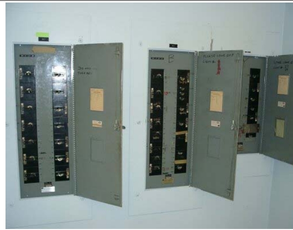
Hallway Panels A, B, Y
